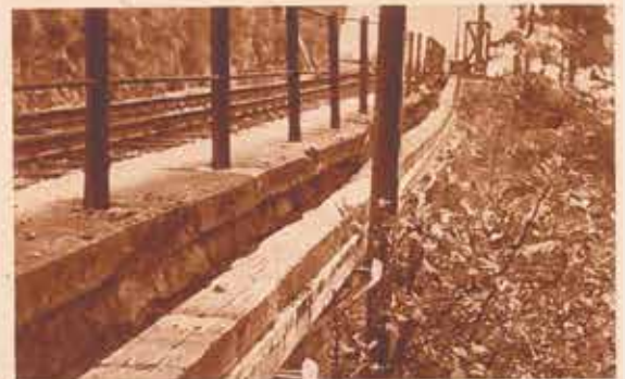
An solch gefährdeten Stellen vermeidet man es auch, die Uebertragungsleitung frei über Masten zu spannen. Man bettet sie dem Geleise entlang in einen Betonkanal.
