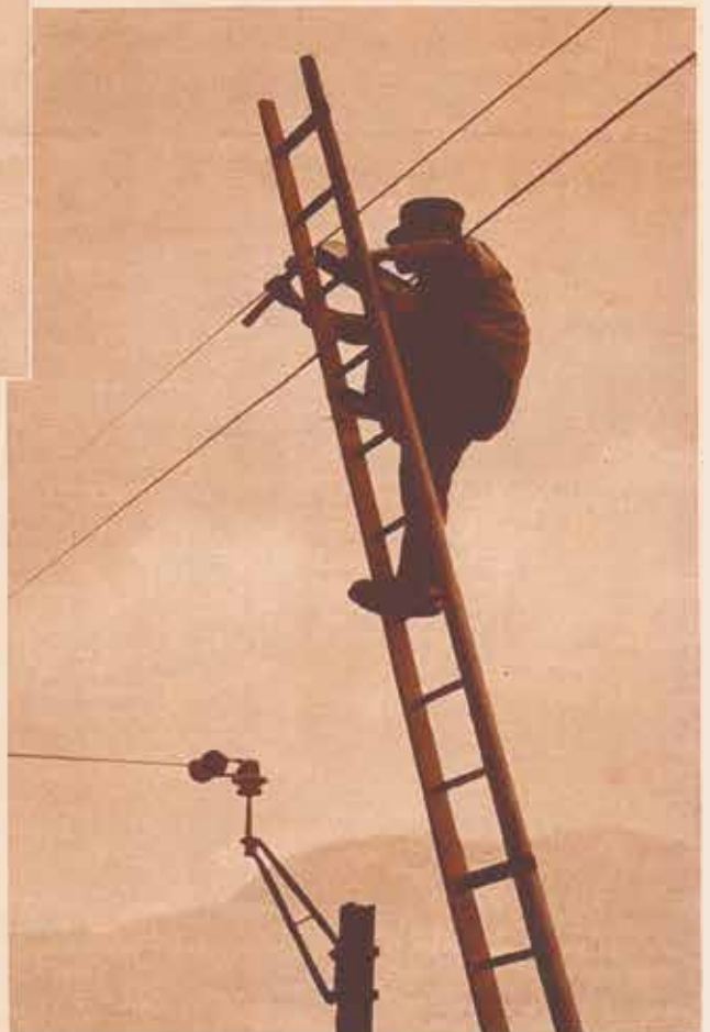
Oft wird durch das stürzende Gestein die Fahrleitung getroffen und beschädigt. Hier sehen wir einen Arbeiter, der rasch eine Beule zushämmert, damit an dieser Stelle der Stromabnehmer des nächsten Zuges keine Funken schlägt.
